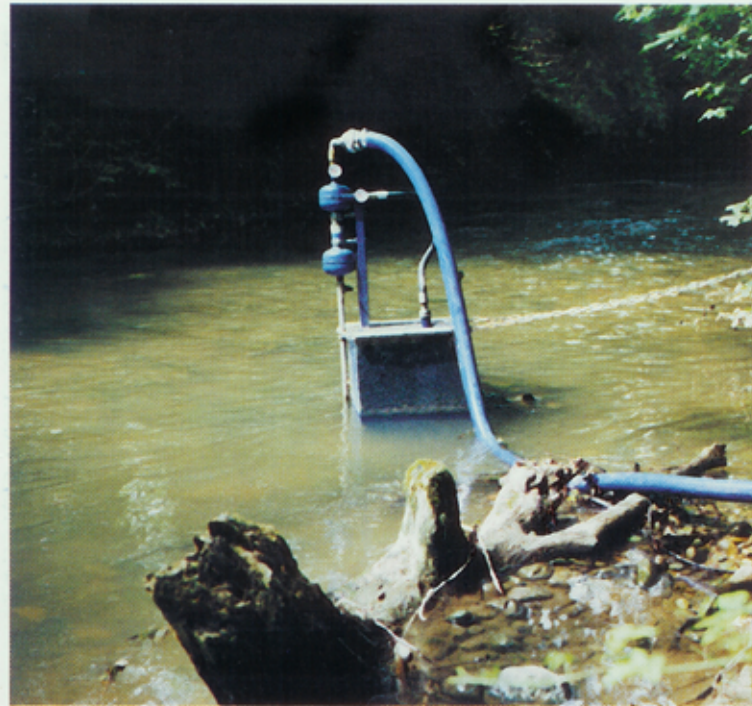
The water is supplied by pumps installed on site. L'eau brute est prélevée au moyen de pompes adaptées au site.
